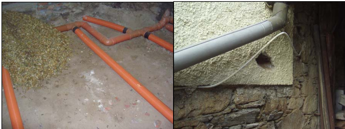
Abb. 11: Luftdrainage im Erdgeschoss und Frischluft-Ansaugöffnung
