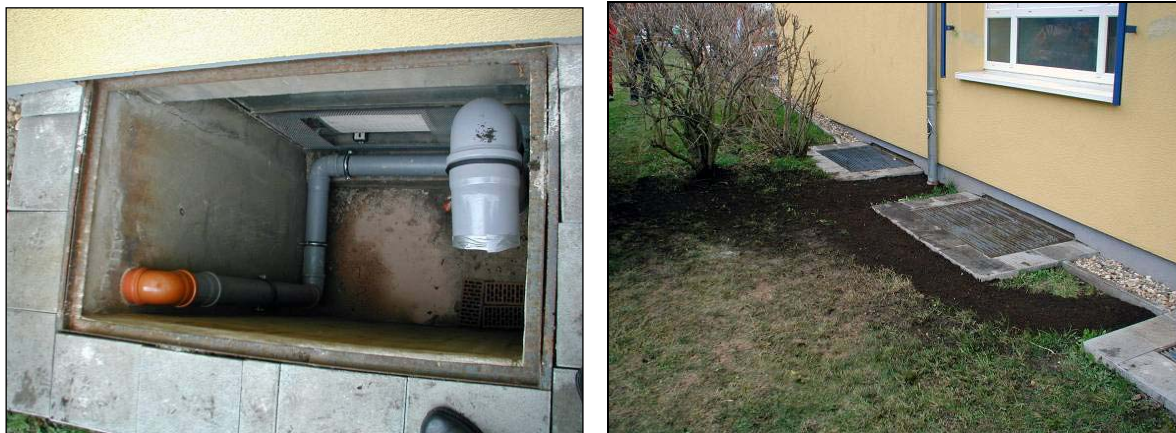
Abb. 10: Ansaug- und Abluftrohr im Lichtschacht; an Abluftleitung angeschlossenes Fallrohr
