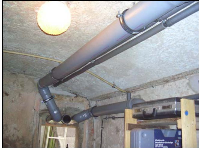
Abb. 13: Kellerabsaugung und Abluftrohre von Bodendrainagen
