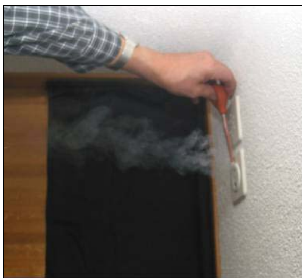
Abb. 1.2: Nachströmung durch die Abschlussdose des Kabelfernsehens im Schlafzimmer Luftvolumenstrom (geschätzt mit Flowfinder-Messung) ca. 2-3 m 3 /h
